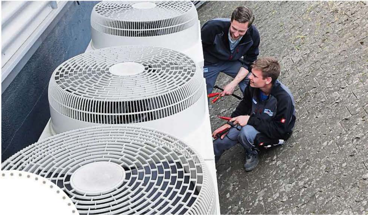
Die Firma Frondorf deckt auch sämtliche Aufgabenbereiche der Elektrik bzw. Elektrotechnik sowie der Klima- und Kältetechnik ab. Fotos: Frondorf Systemtechnik GmbH
